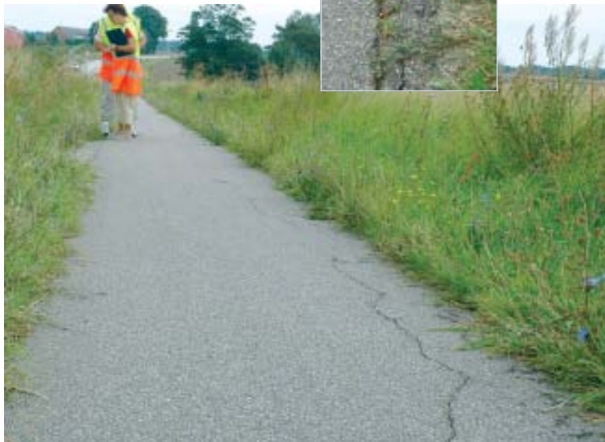
Vegetationen langs cykelstier vokser ind i revner i belægningen og ødelægger kanterne.
