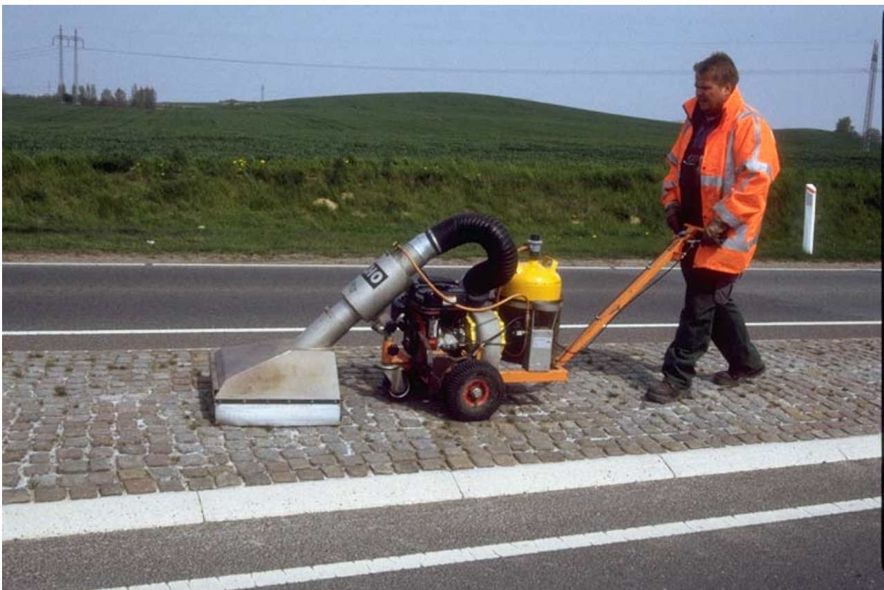
Figur 5. Hedluftbehandling i Ugerløse den 29. april. De hvide fuger mellem chaussestenene skyldes krystallisering af restsalt fra glatførebekæmpelsen.
