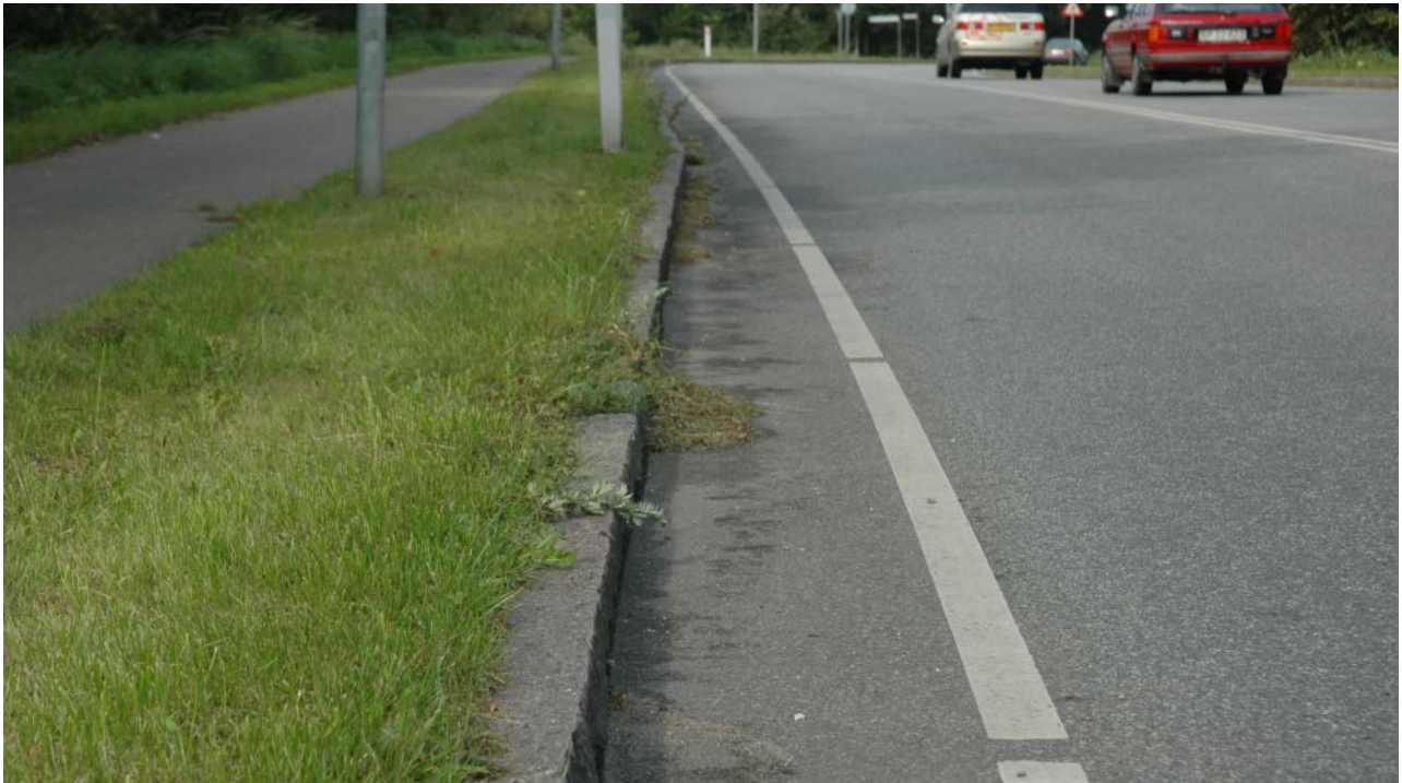
Figur 2. Billede fra Kalundborg den 24. august. Nye kantsten og asfaltbelægning af høj kvalitet. Midt i billedet ses en samling af græsafklip. Der har været foretaget græsslåning mellem seneste fejning og besigtigelsen.
